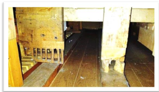
強度が不足した支柱
